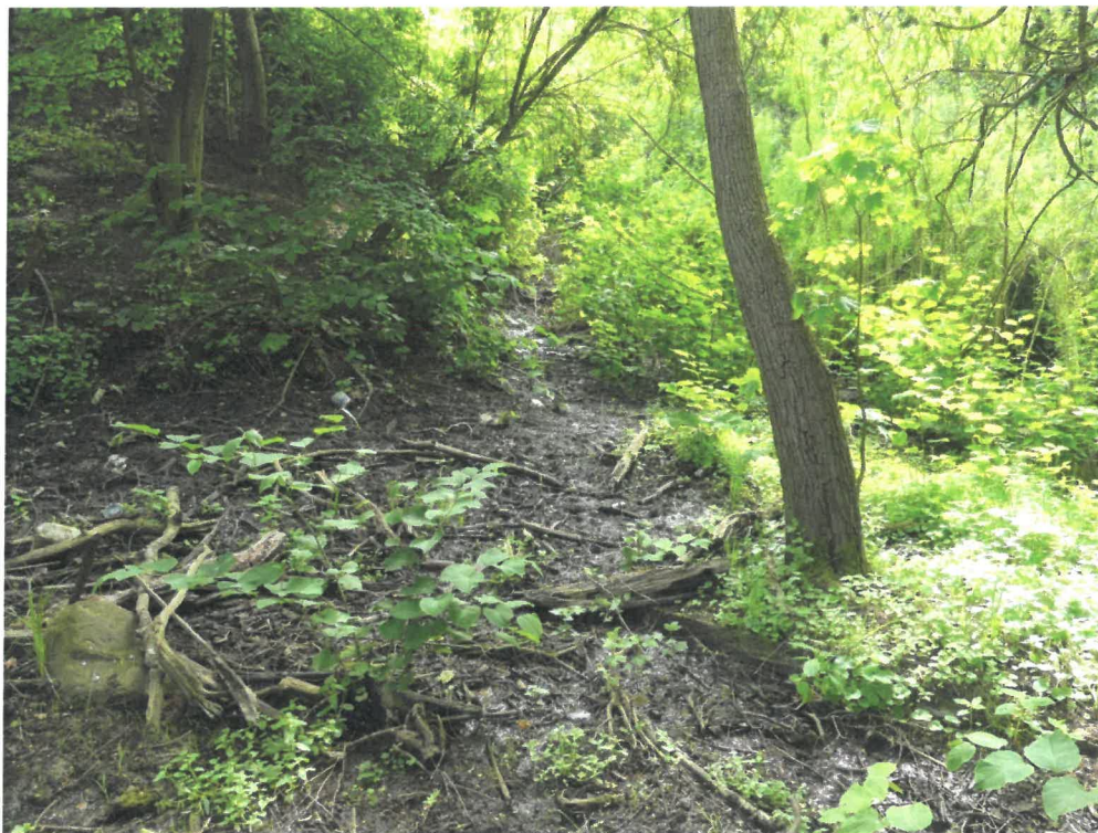
Fot. 1. Wyptywy i wysięki z skarpy głównej osuwiska.
