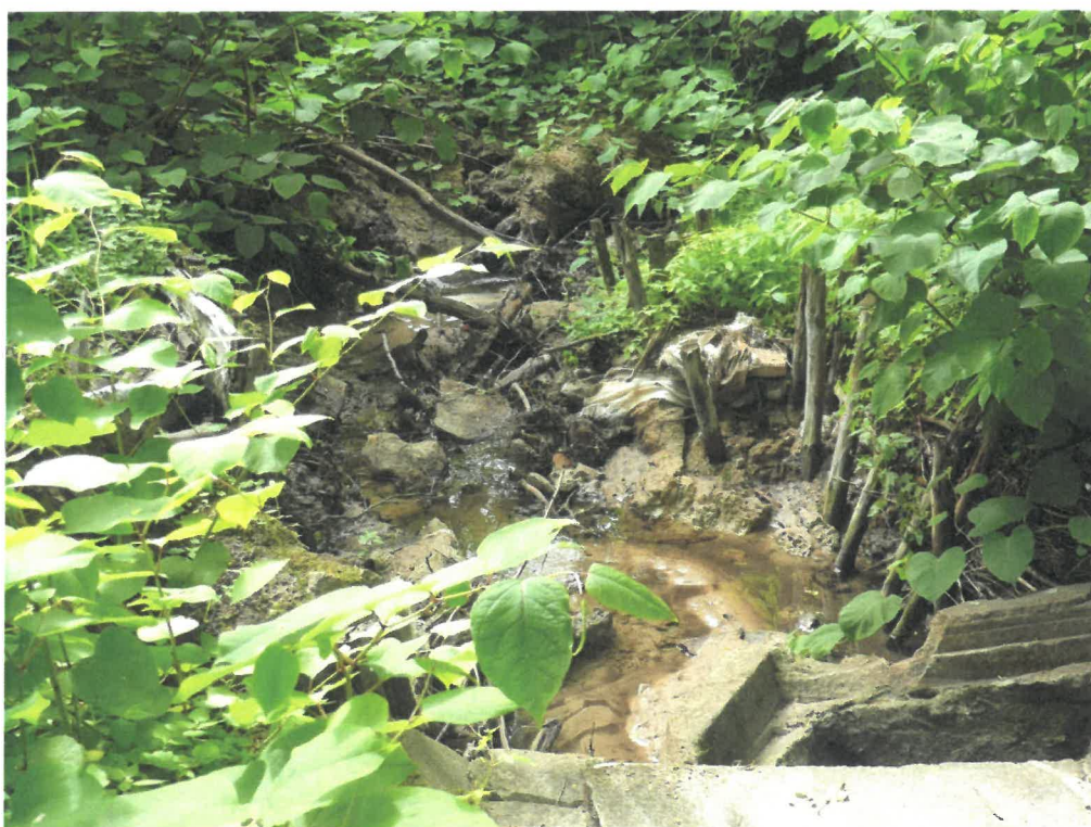
Fot. 2. Zaciśnięte koryto ciekum materiałem koluwalnym.
